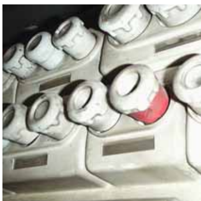
Fig. 1: elemento in ceramica difettoso, rischio di elettrocuzione
